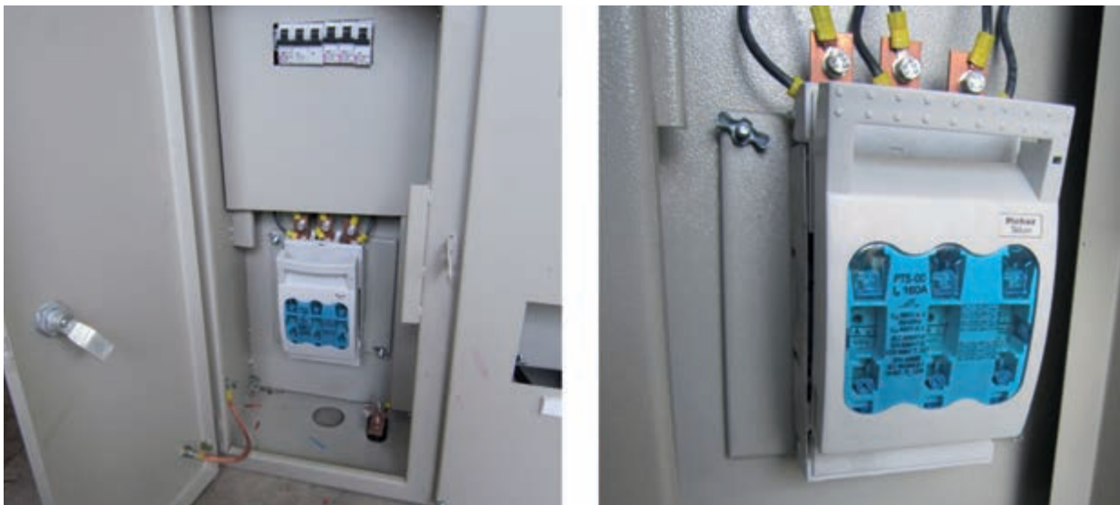
شکل ۲۳-۳- محل ورود کابل اصلی به داخل تابلو
