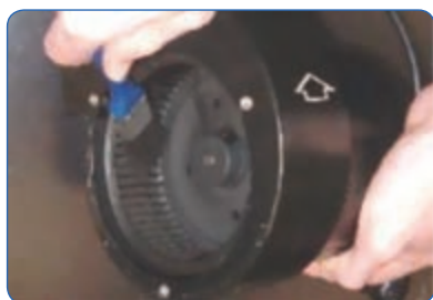
تمیزکردن فن مشعل از گردوغبار
