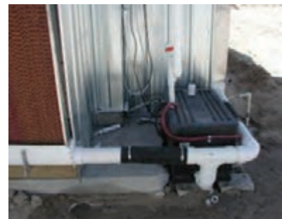
تصویر ۱۲-۲- پمپ و لوله های توزیع آب
