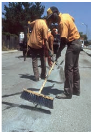
شکل ۳۴- استفاده از جارو برای پخش ماسه بر روی ماده درزگیر ترک اشتباه است
