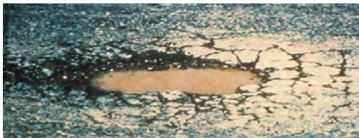
شکل ۳۸- گودال در سطح جاده ناشی از بالا آمدن آب زیرزمینی
