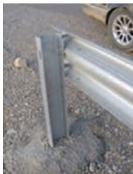
شکل ۶۳- اجرای پایه حفاظ به روش ناصحیح
