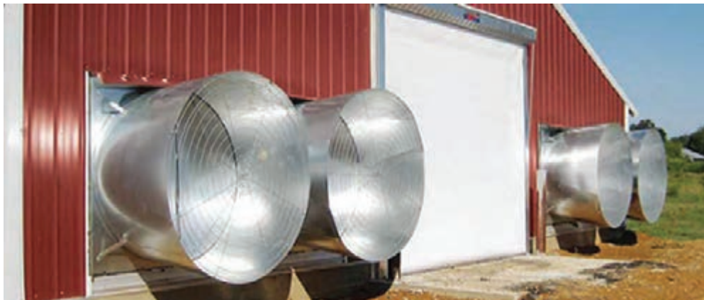
نصب هواکش‌ها به صورت قرینه در تهویه تونلی
