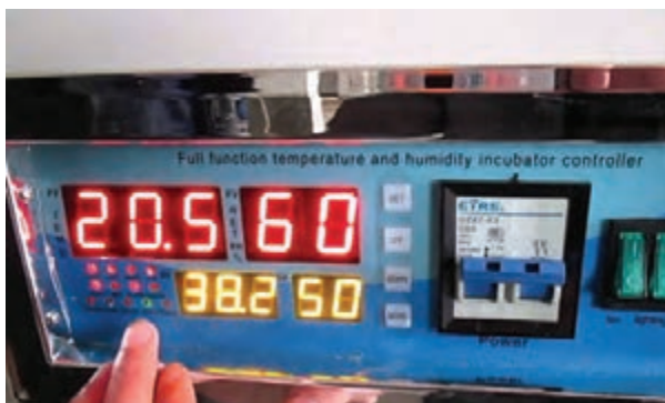
تابلوی کنترل دما، رطوبت و چرخش در دستگاه ستر
