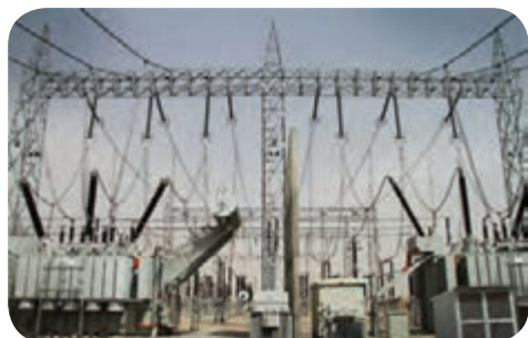
شکل ۱۷- پست انتقال برق
