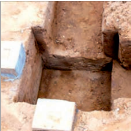
شکل ۱-۸۱ پی کنی از نوع پی کلاف‌بندی شده (پی منفرد و شناژ) جداره‌های اطراف پی نقش قالب را ایفاء می‌کنند.
