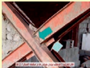
ضعیف بودن جوش و عدم اتصال مناسب
