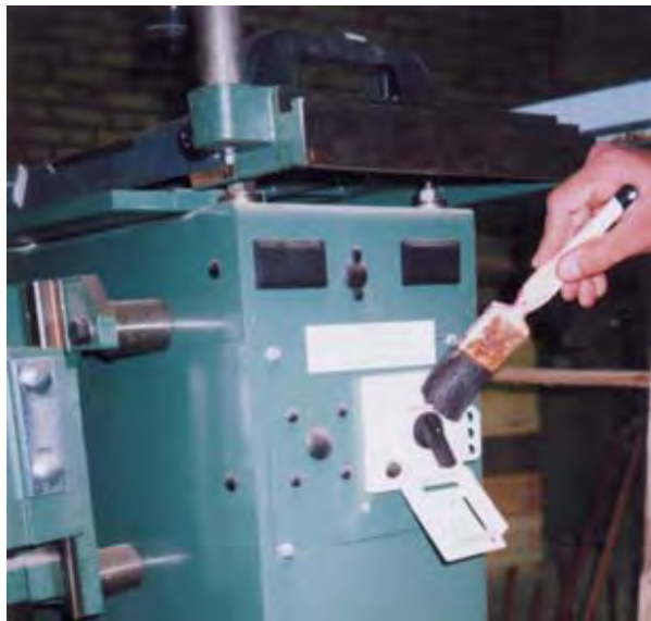
شکل ۱۰-۱۵- گردگیری و تمیز کردن کلید برق.
