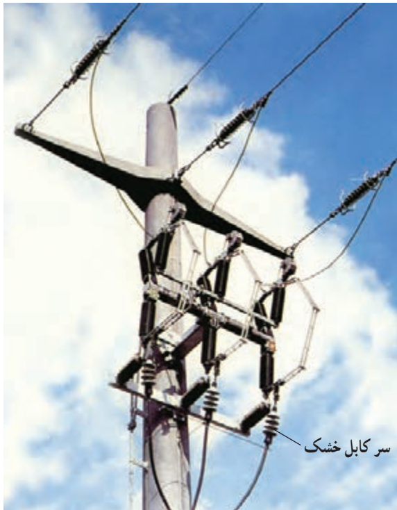
شکل ۶-۶- سر کابل خشک حرارتی هوایی
