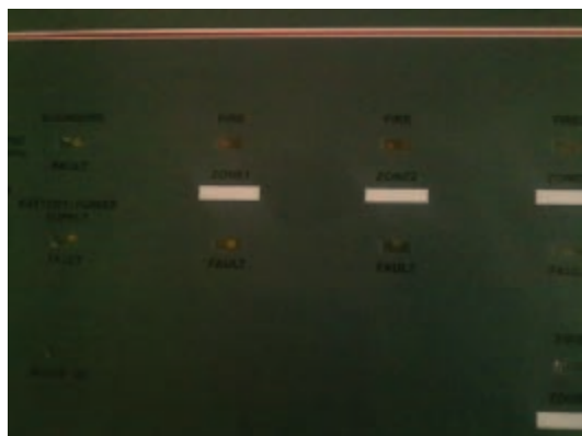
شکل ۱-۳۳ لامپ های قرارداده شده در داخل تابلو
