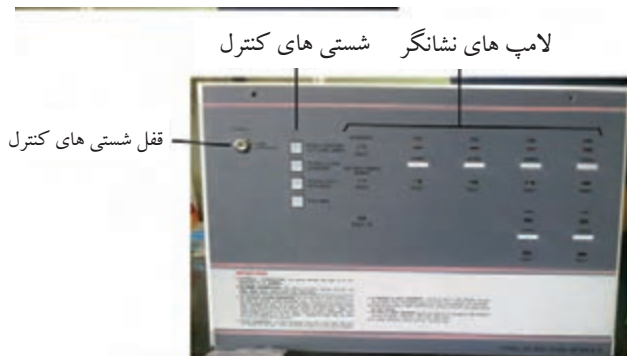
شکل ۱-۳۲ قسمت های بیرونی تابلوی کنترل مرکزی را نشان می دهد.
