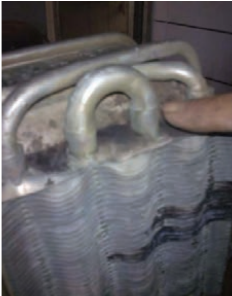
شکل ۱۱- تشکیل رسوب در آب گرم‌کن
