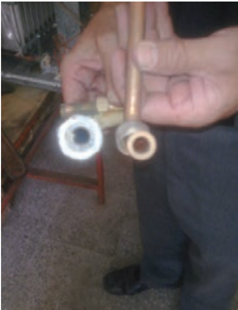
شکل ۱۲- تشکیل رسوب در لوله آب گرم
