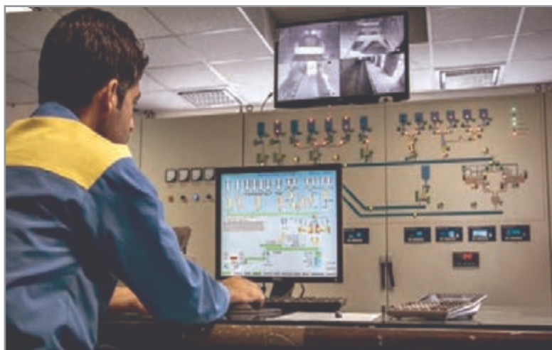
شکل ۲۸- اتاق فرمان (کارخانه شیشه اردکان)
