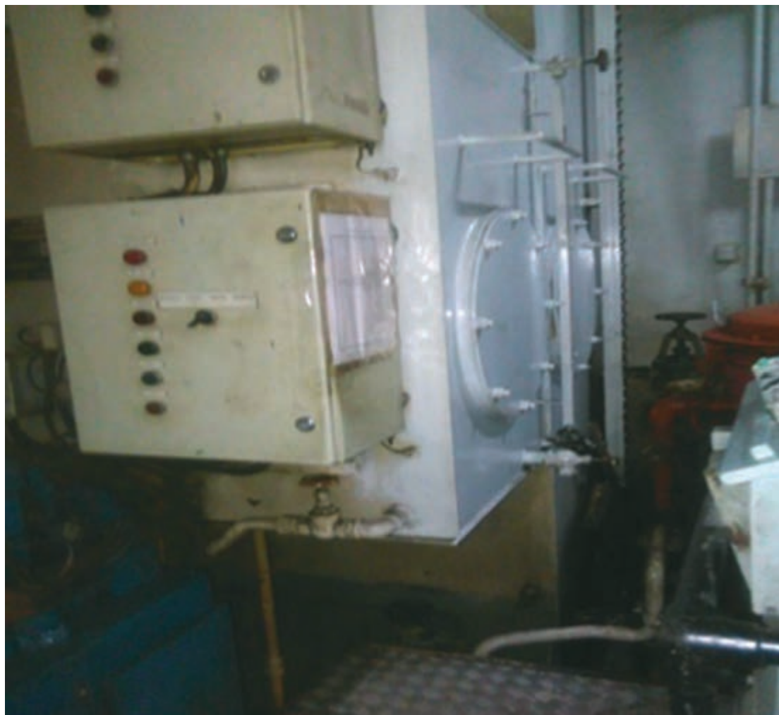
شکل ۲۳- مخزن سوخت روزانه یک شناور
