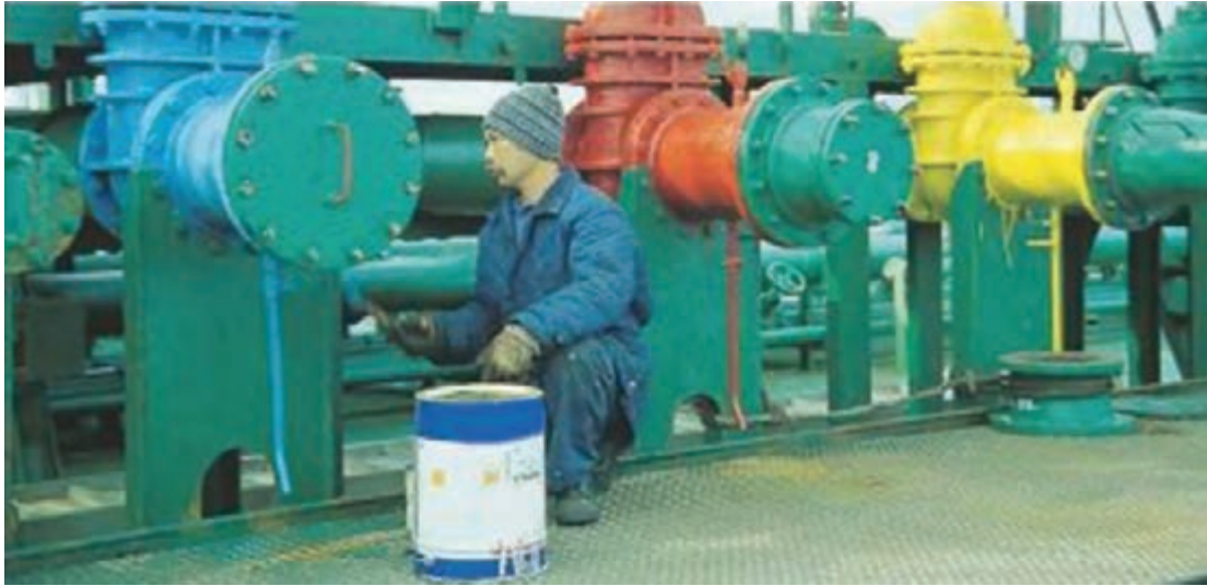
شکل ۵۵- رنگ آمیزی سامانه‌های لوله‌کشی بر روی عرشه
