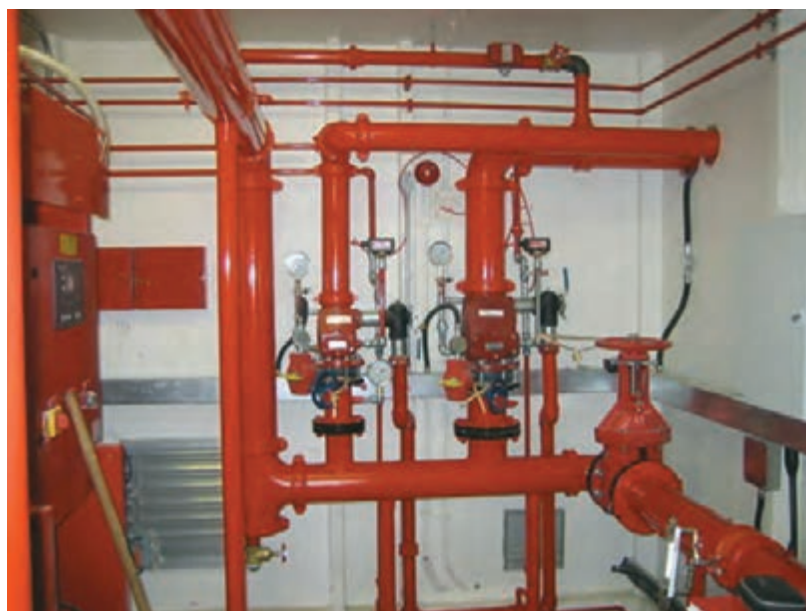
شکل ۱۰- قسمتی از سامانه آتش‌نشانی یک شناور
