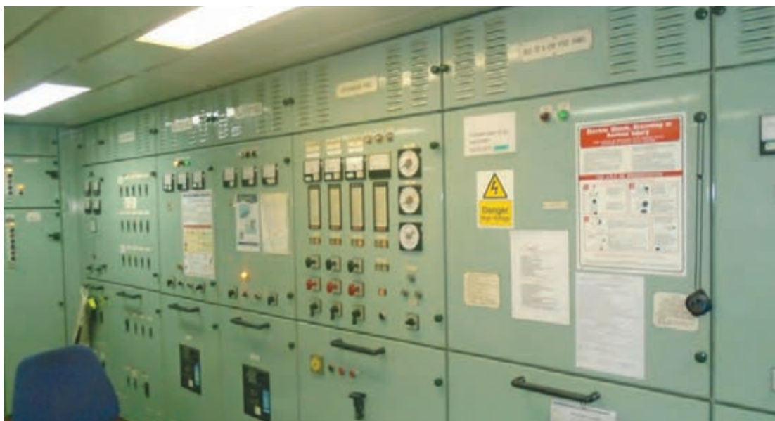
شکل ۲۳- تابلوی اصلی برق شناور
