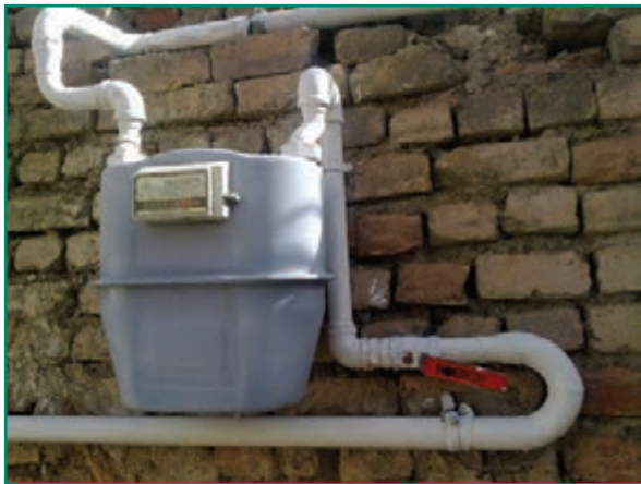
شکل ۸۱-۴ یک کنتور ۱۰ متری نصب شده
