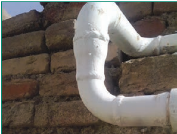
شکل ۸۲-۴ الف قبل از ورود به کنتور لوله از \frac{1}{4} به ۱ تبدیل شده است
