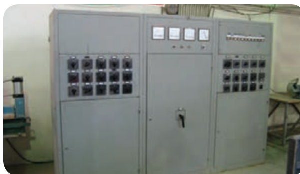
شکل ۸۳-۵: تابلوی اصلی سه فاز برق کارگاه
