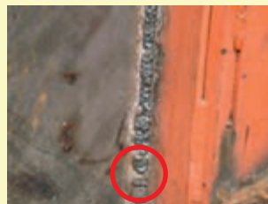
عدم جوش پیوسته - لوچه
