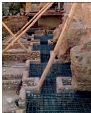
شکل ۹۰-۱ مهاربندی با شمع چوبی
