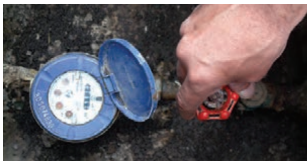
شکل ۱۴۰-۲ بستن شیر فلکه‌ی اصلی
