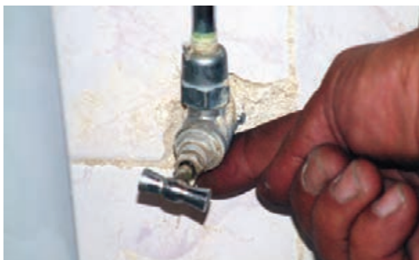
شکل ۱۴۷-۲- کنترل نشت آب از محل اتصال
