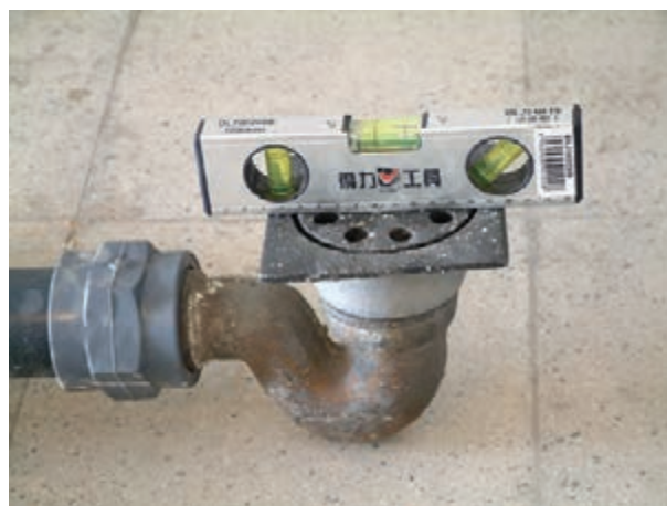
کف شوی نصب شده بر روی سیفون شترگلی
