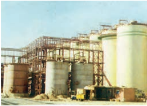
شکل ۱-۳۹- تأسیسات نفتی در جنوب
