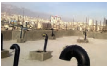
شکل ۲-۵۳ لوله‌های هواکش روی پشت‌بام
