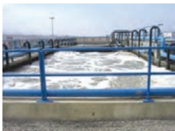
▲ شکل ۸-۲ تصفیه خانه آب
