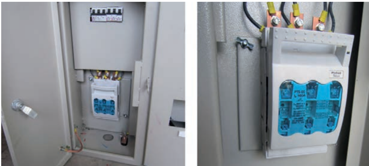
شکل ۲۳-۳- محل ورود کابل اصلی به داخل تابلو
