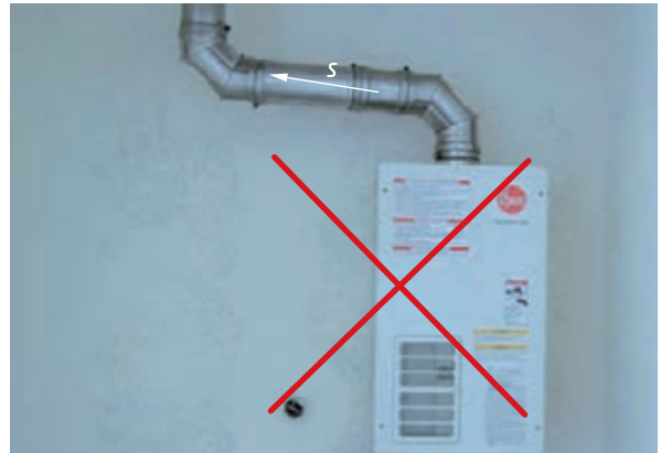
شکل ۱-۳۶ اتصال نادرست دودکش
