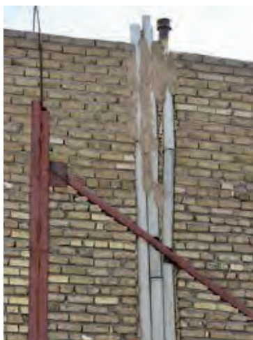
شکل ۴-۶ الف دودکش نادرست
