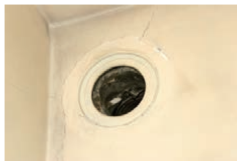
شکل ۱-۴ دودکش در محل نصب آب گرم کن.
