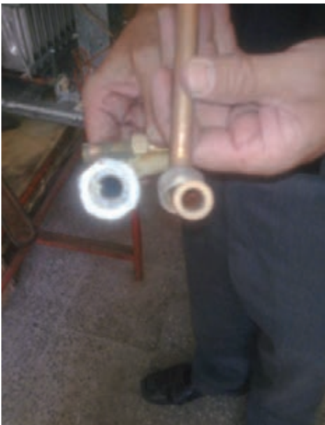
شکل ۱۲- تشکیل رسوب در لوله آب گرم
