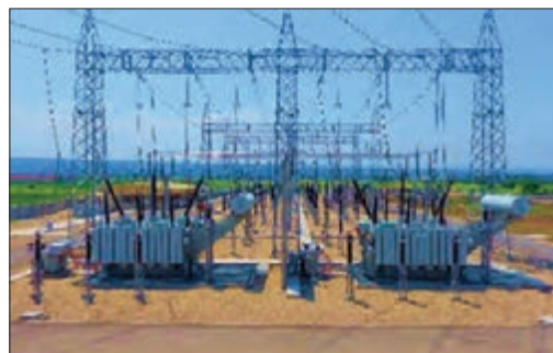
شکل ۳- پست تقویت ولتاژ
