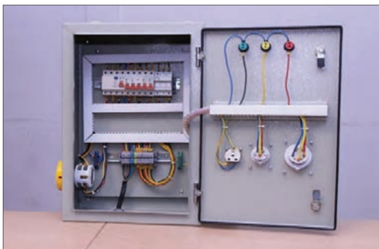
شکل ۵۸- نمای مختلف تابلو توزیع کارگاهی
