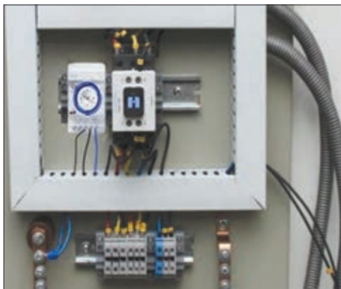
شکل ۱۰۷- محل نصب تایمر ۲۴ ساعت در تابلو روشنایی
