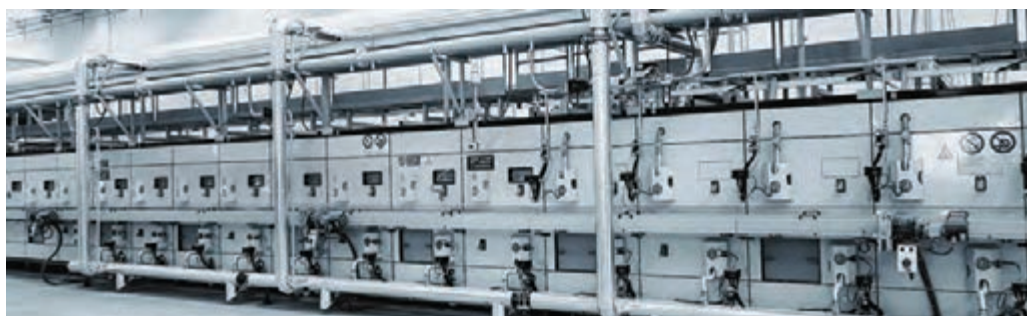
شکل ۱۱- ناحیه زینترینگ کوره پخت کاشی
