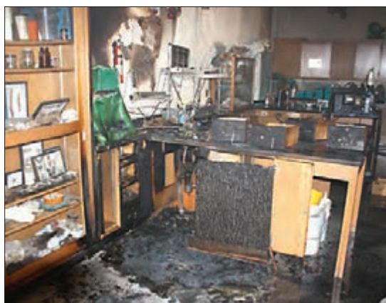
شکل ۱۸- تصویری از سائحه روی داده به دلیل نگهداری نادرست مواد آتش‌گیر
