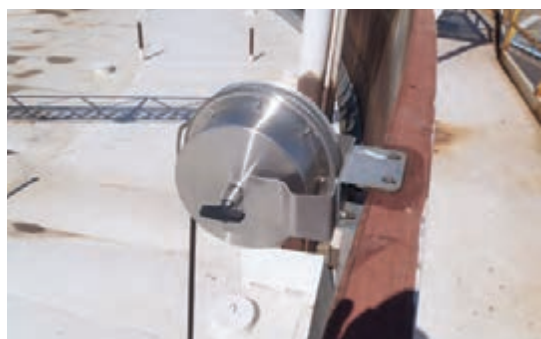
شکل ۲۷- تخلیه الکتریسیته ساکن در مخزن سقف شناور
