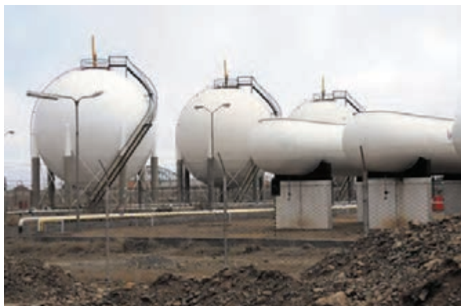
شکل ۱۶- مخازن تحت فشار
