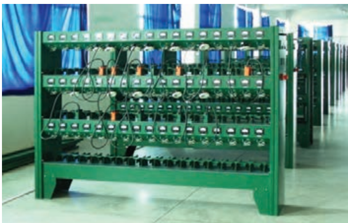
شکل ۹ - نمایی از قفسه های چراغ خانه معدن جهت شارژ باتری ها
