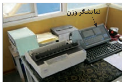
اتاقک کنترل باسکول
