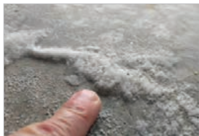
شکل ۸- ایجاد شوره بر روی قالب گچی
