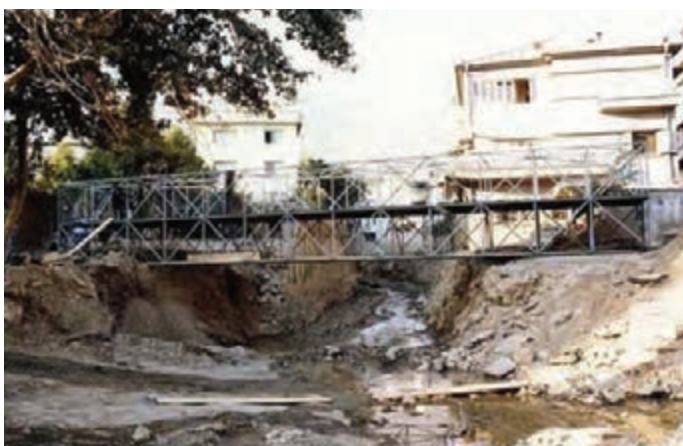
شکل ۲۶-۱- تخریب ساختمان‌ها و مسیر رود تجریش بر اثر سیلاب گلابدره تهران، مرداد ماه ۱۳۶۶
