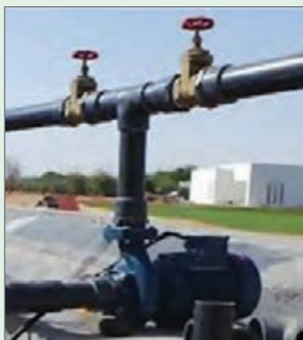
شکل ۴۷- شیرفلکه لوله رانش
