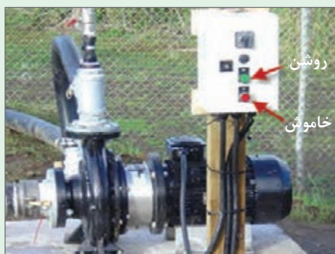
شکل ۲۸- کلیدهای کنترل روی تابلو
