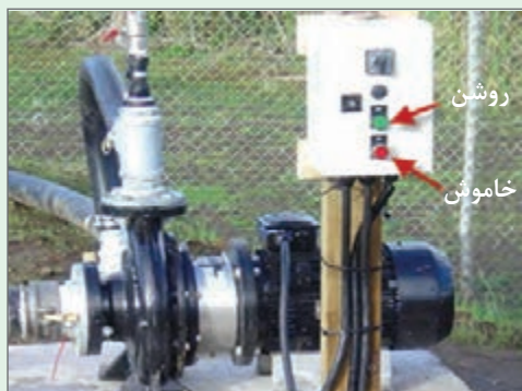
شکل ۵۱- کلیدهای کنترل روی تابلو
