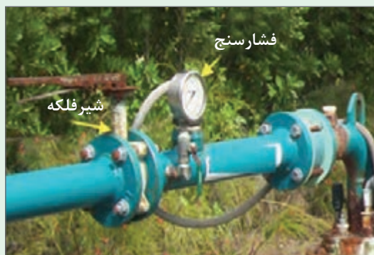
شکل ۵۰- محل شیر فلکه و فشارسنج روی لوله رانش
