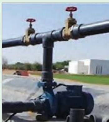
شکل ۲۶- شیرفلکه لوله رانش
