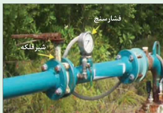
شکل ۲۷- محل شیر فلکه و فشارسنج روی لوله رانش
