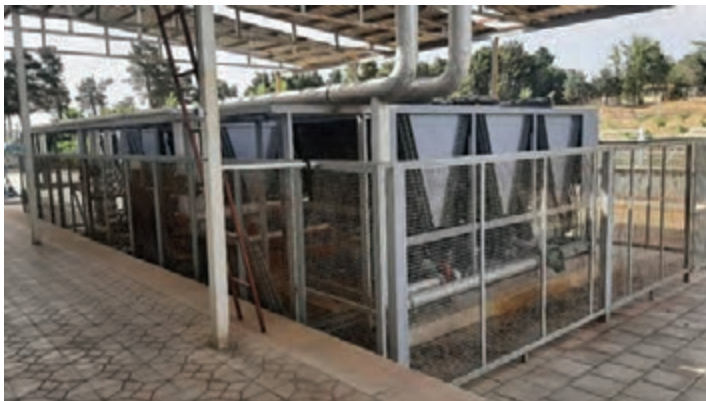
شکل ۹- سیستم‌های سرمایشی چیلر در یک واحد جوجه‌کشی
