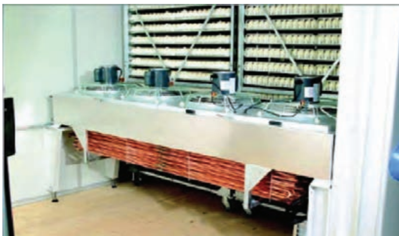
شکل ۸- شبکه‌ای از لوله‌های مسی برای خنک‌سازی دستگاه جوجه‌کشی
