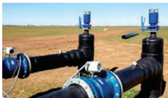
شکل ۳۰- شیر تخلیه هوا دستی
