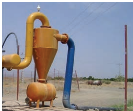
شکل ۵۷- استفاده از هیدروسیکلون در ایستگاه پمپاژ
