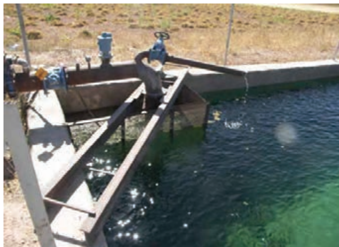
شکل ۱۶- استخر ذخیره آب جهت پمپاژ در سامانه آبیاری بارانی
