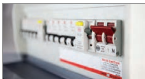
شکل ۱۸- تابلوی توزیع برق واحد مسکونی
