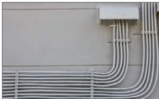
شکل ۱۶- لوله غیر فولادی و خم مسير
