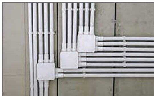
شکل ۱۵- لوله غیر فولادی در سیم‌کشی برق
