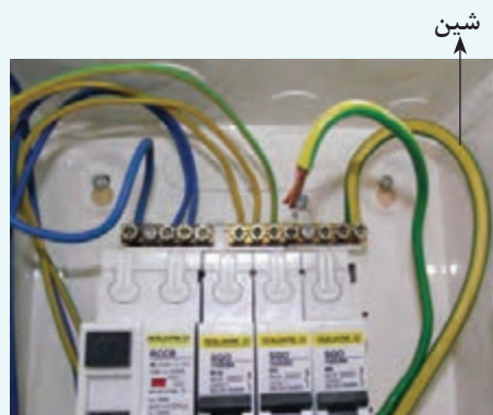
شکل ۷- باز کردن هادی همبندی از شین اتصال زمین
