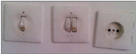
شکل ۱- نصب غلط کلید و پریز
