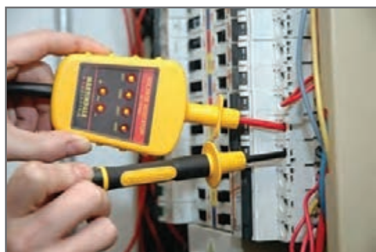
شکل ۵۴- تست تابلو با نشانگر ولتاژ
