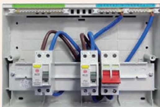
شکل ۴۷- سیم‌کشی قطعات تابلو
