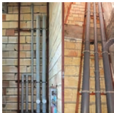
شکل ۲۵- نمونه کار لوله فاضلاب و هواکش پوش فیت و PVC
