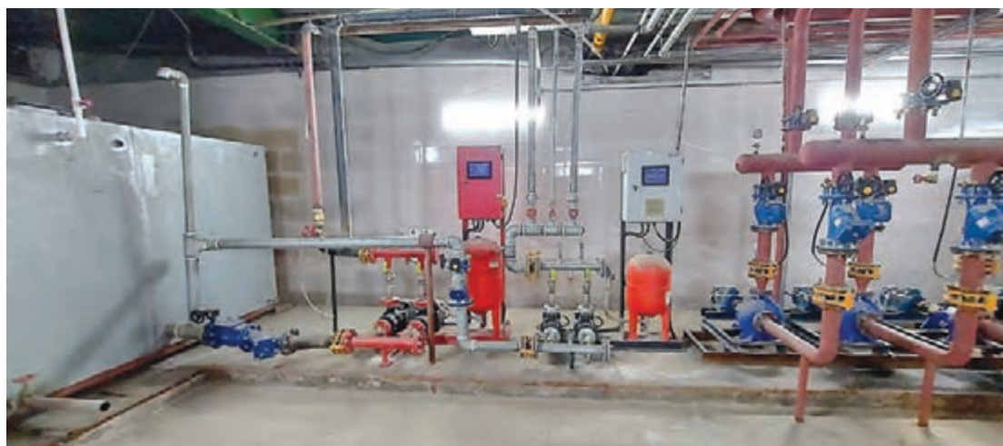
شکل ۲۰- بوستر پمپ آبرسانی و آتش‌نشانی و مخزن ذخیره مشترک
