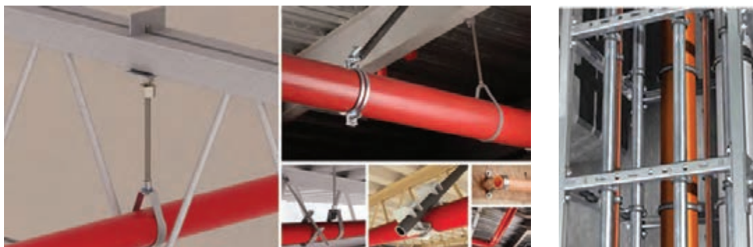
شکل ۶- نمونه ای از تکیه گاه ها و نگهدارنده های لوله های آتش نشانی
