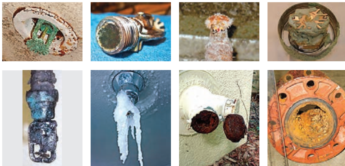
شکل ۵۷- ایجاد رسوب در لوله و تجهیزات
