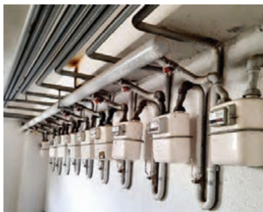
کلکتور با لوله کشی گاز روکار
