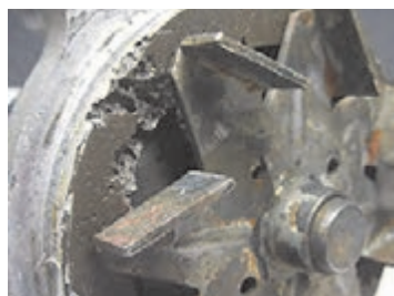
ج) خرابی بلبرینگ و خوردگی داخلی
