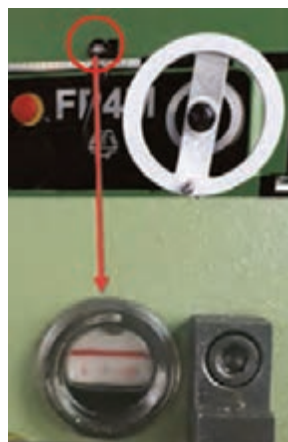
شکل ۱۷- کنترل سطح روغن در چشمی
