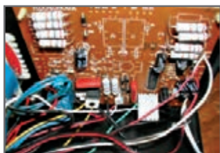
شکل ۱۳۲- برد الکترونیکی و کنترل شدت هوای فشرده
