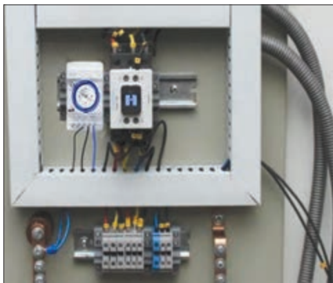
شکل ۱۰۷- محل نصب تایمر ۲۴ ساعت در تابلو روشنایی
