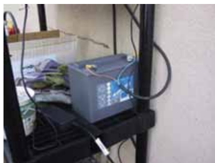
شکل ۵-۵۴- اتاق شارژ باتری
