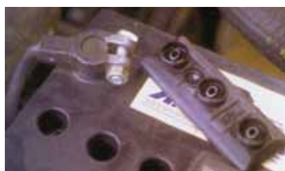
شکل ۵-۱۶- باز کردن درپوش خانه‌های باتری
