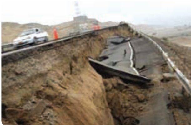
شکل ۵۴-۱- تخریب ناشی از زلزله
