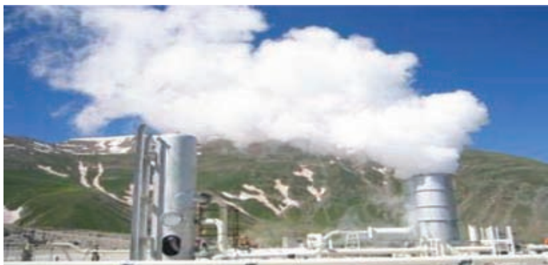
شکل ۳۲-۵- تأسیسات زمین گرمایی مشکین شهر
