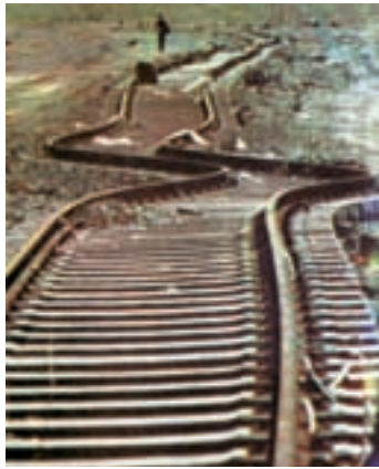
شکل ۶-۶- تخریب خط آهن بر اثر وقوع زلزله
