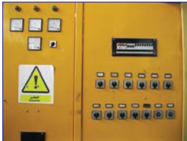
شکل ۱-۵- نمونه‌ای از تابلو برق
