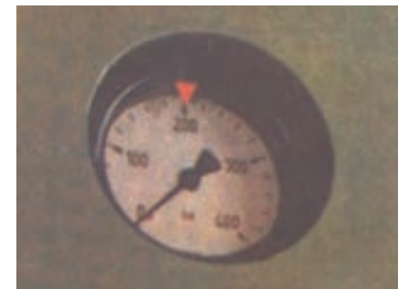
شکل ۲-۵۷ کنترل فشار روغن هیدرولیک
