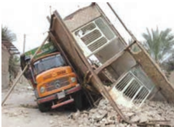
(د) ریزش دیوار در اثر زلزله
