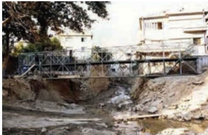
شکل ۲۴-۱- تخریب ساختمان‌ها و مسیر رود تجریش بر اثر سیلاب گلابدره تهران، مرداد ماه ۱۳۶۶
