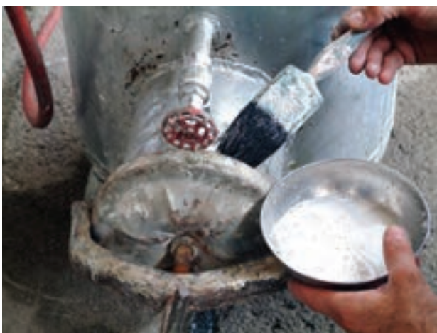
شکل ۲-۳۹- کنترل نشستی گاز
